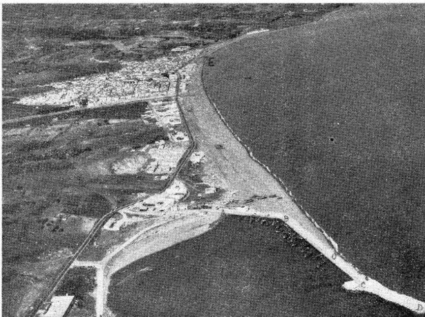
Foto 2.ª — Estepona: Tercera alineación del dique de Levante, en construcción. Posición de la playa después de un fuerte temporal de Levante.
