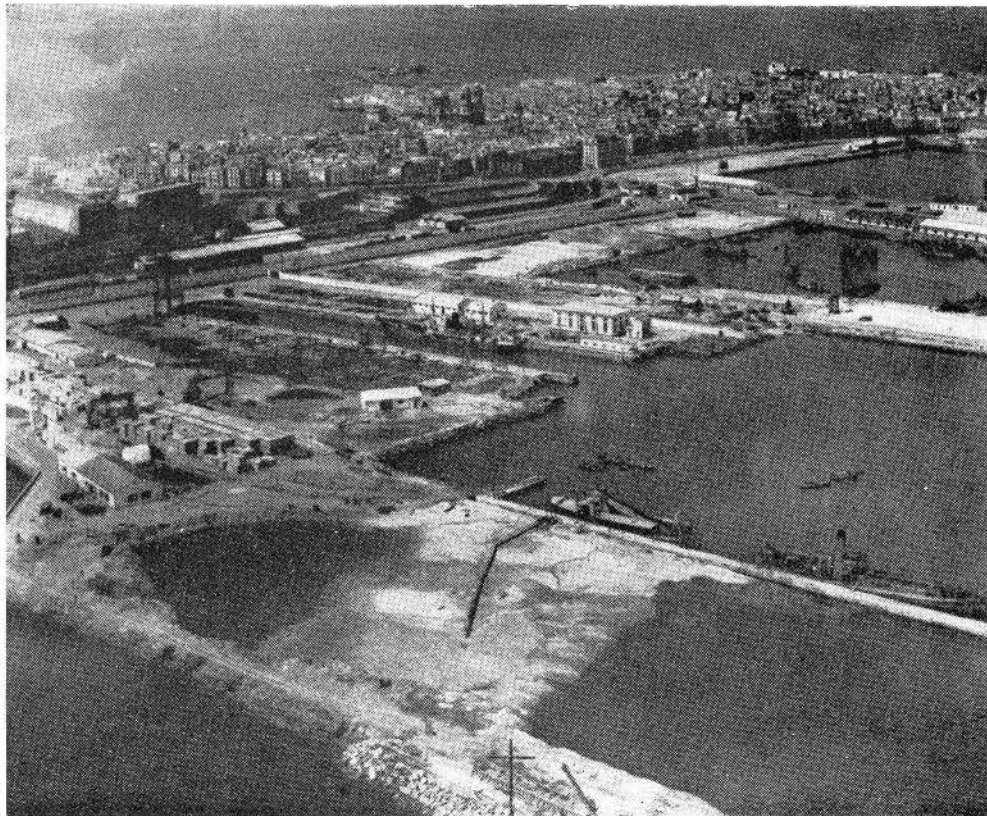
Vista aérea de la dársena del dique seco, durante la construcción de los muelles de armamento y embocadura. En segundo término, el fondo de la dársena pesquera con los muelles en construcción.
