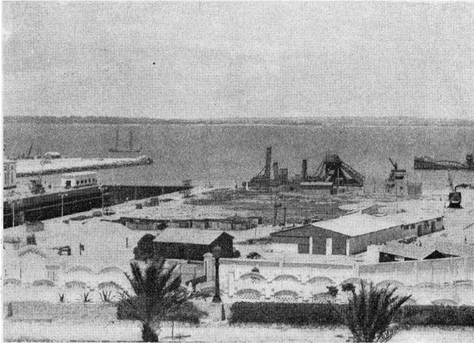
La dársena del dique seco, sin muelles ni abrigos, al iniciarse su ordenación. A la izquierda, el cuenco y la puerta del dique.
